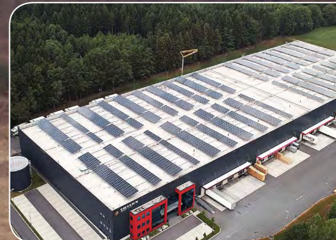
PV-Dachanlage auf Industriehalle mit 564 kWp
