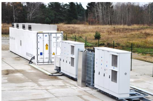
Foto: BELECTRIC EBU auf dem Solarkraftwerk in Alt Daber
